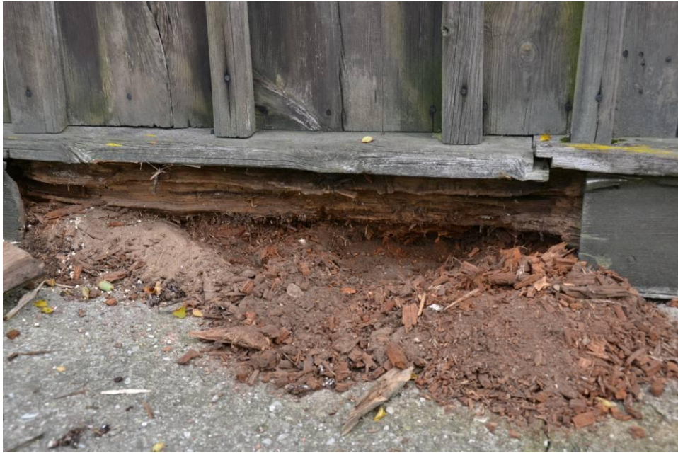
Skorodowana całkowicie podwalina porażona przez owady i grzyby domowe od strony zachodniej
