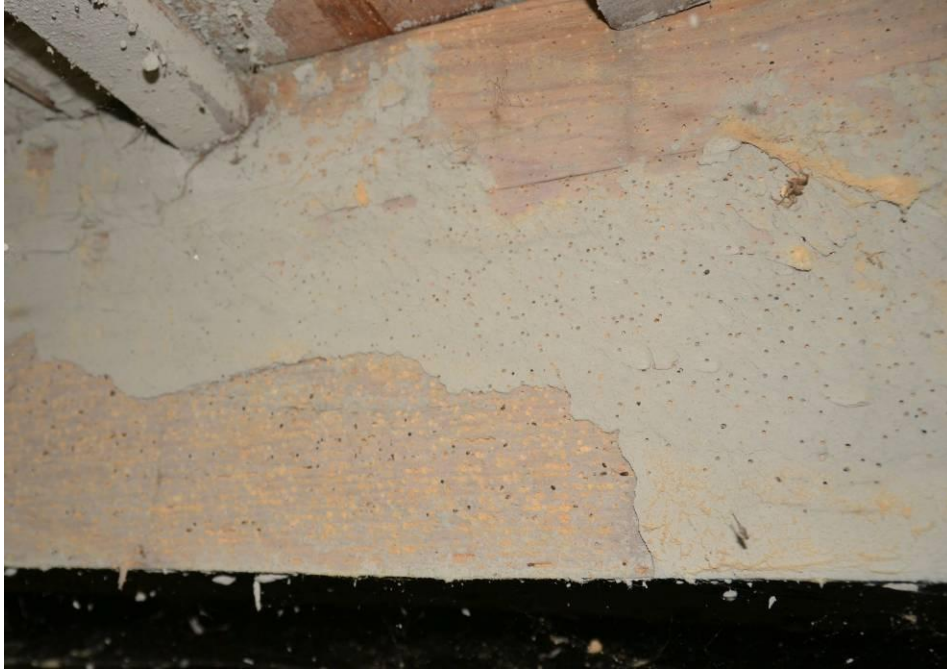
Liczne otwory wylotowe owadów świadczy o mocnym porażeniu drewna przez owady – techniczne szkodniki drewna budowlanego
