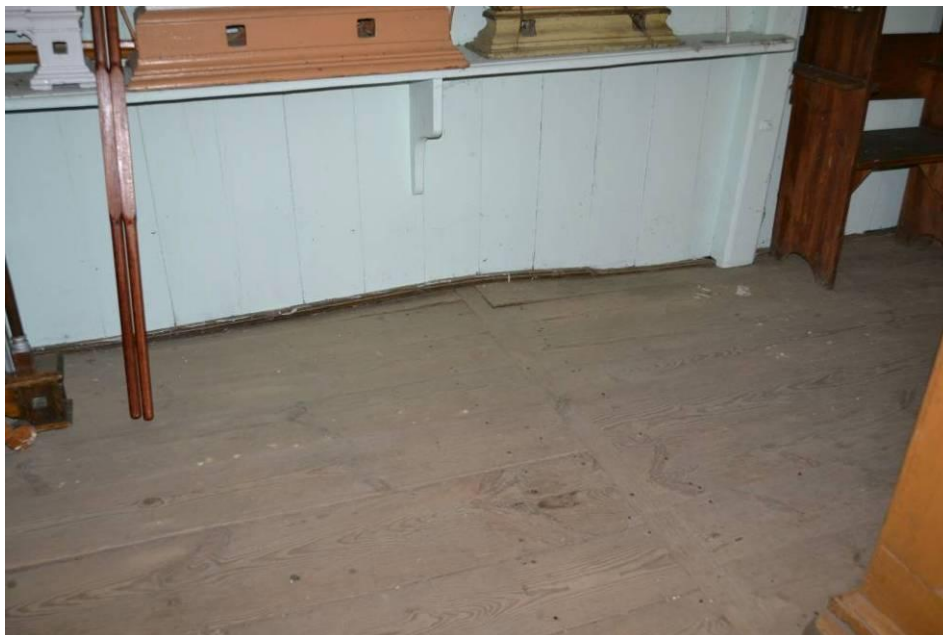
Nierównomierne osiadanie ściany zachodniej z powodu korozji biologicznej podwaliny
