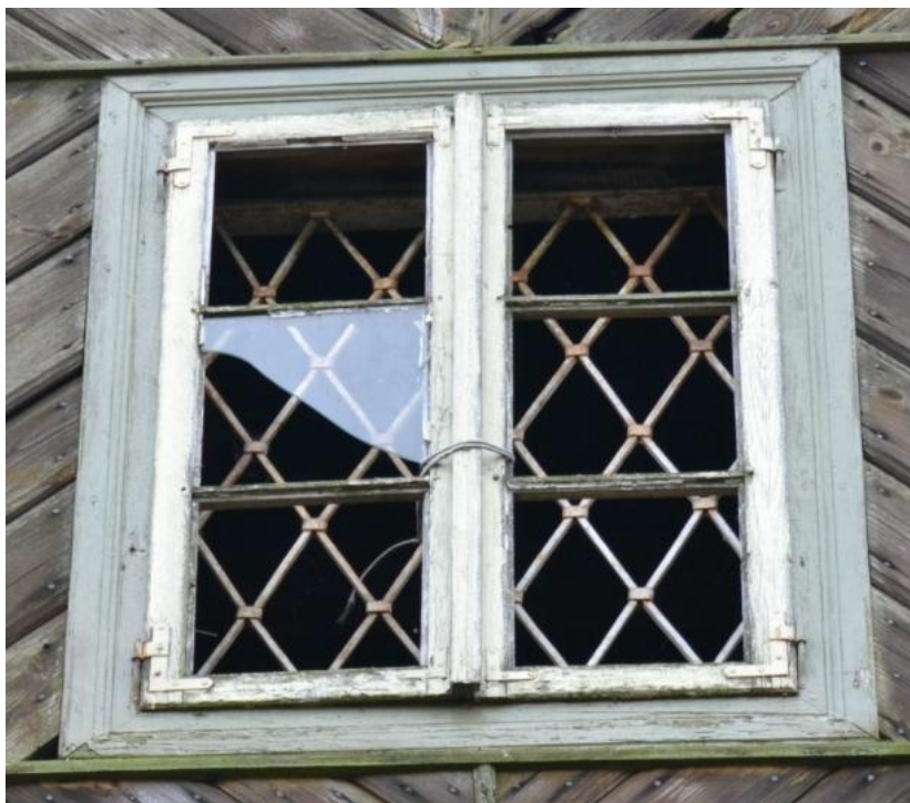
Okno na strychu od strony północnej - brak oszklenia.
