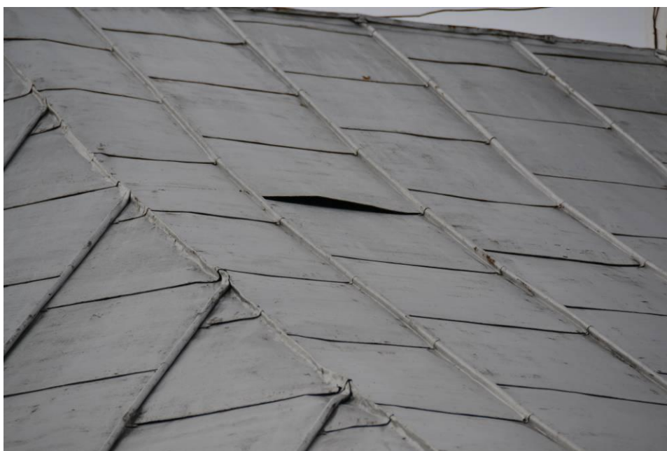
Nieszczelności połączeń arkuszy blachy na połaci wschodniej.
