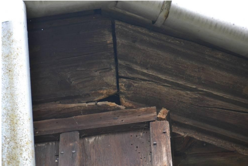
Porażone przez owady deski szalunkowe od strony zachodniej nad prezbiterium.
