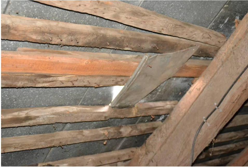
Zniszczony kanał odprowadzający parę wodną z nawy wschodniej
