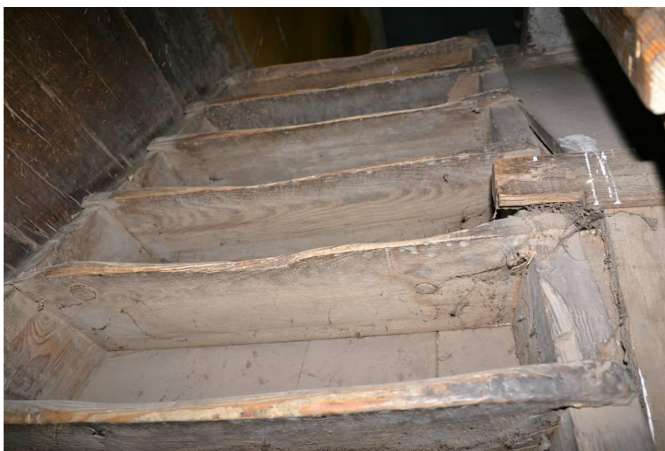
Zniszczone deski stopni w schodach polickowych na chór muzyczny.
