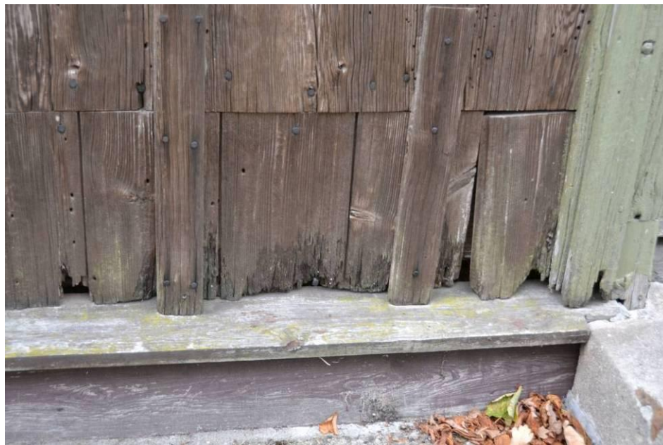
Porażone przez owady i grzyby domowe deski szalunkowe od strony zachodniej.
