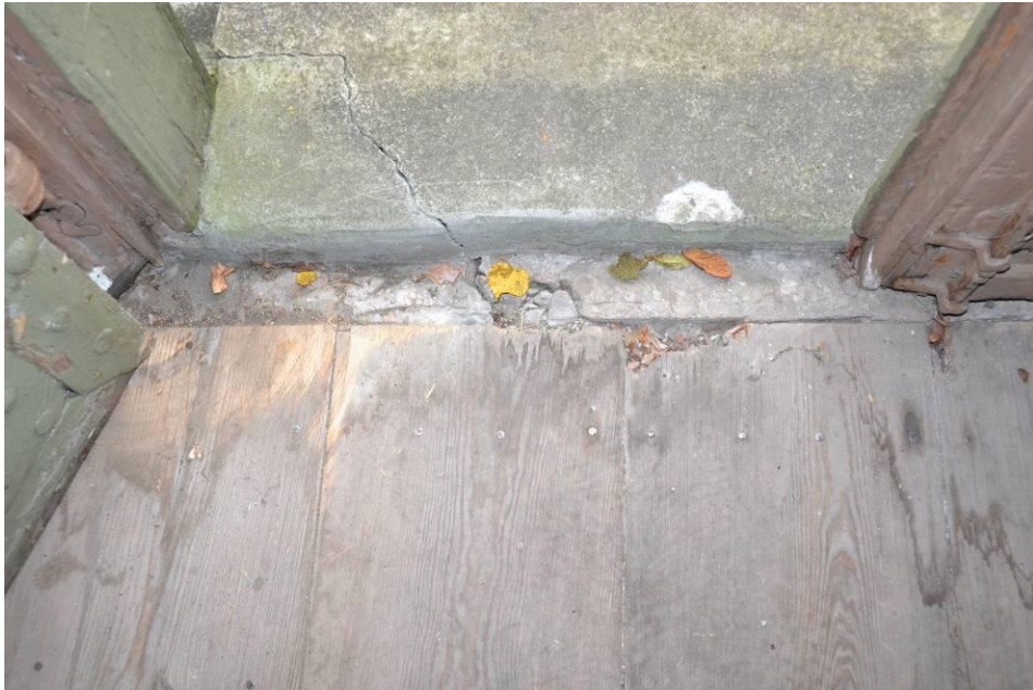
Brak progu w drzwiach zewnętrznych od strony północnej.
