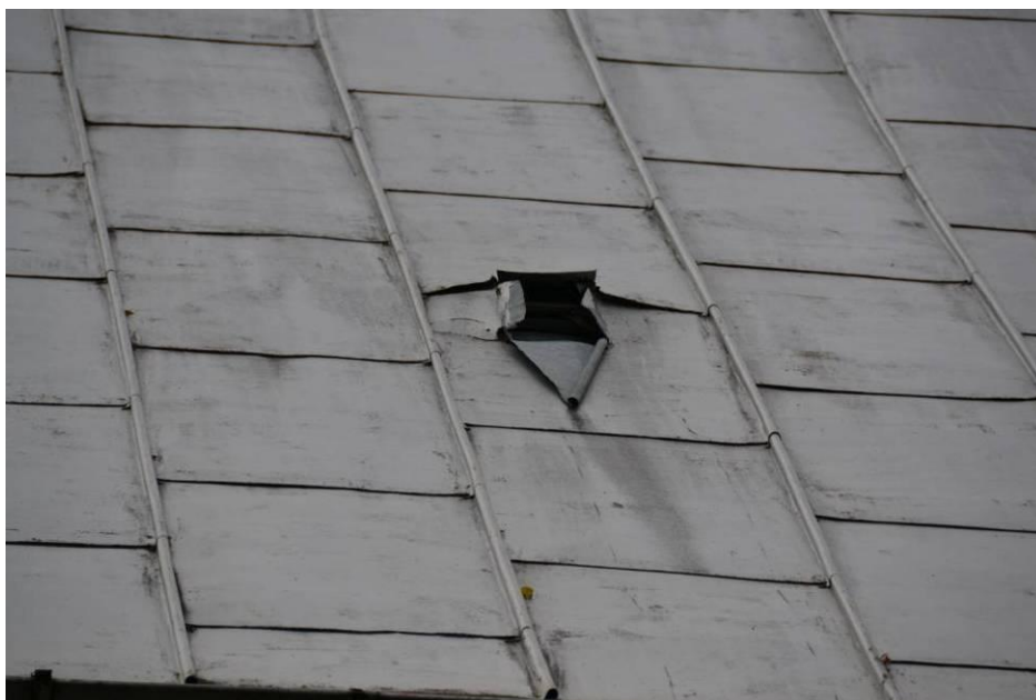
Zniszczony wywietrznik na dachu od strony wschodniej.
