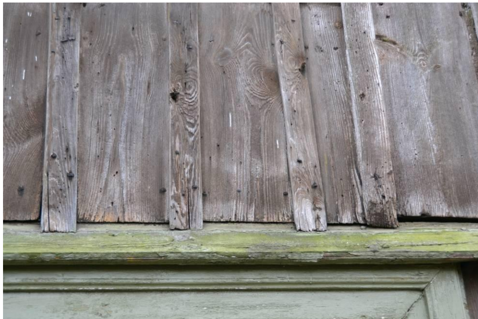
Porażone przez owady deski szalunkowe nad wejściem głównym od strony północnej oraz porażona przez grzyby deska okapowa nad drzwiami.
