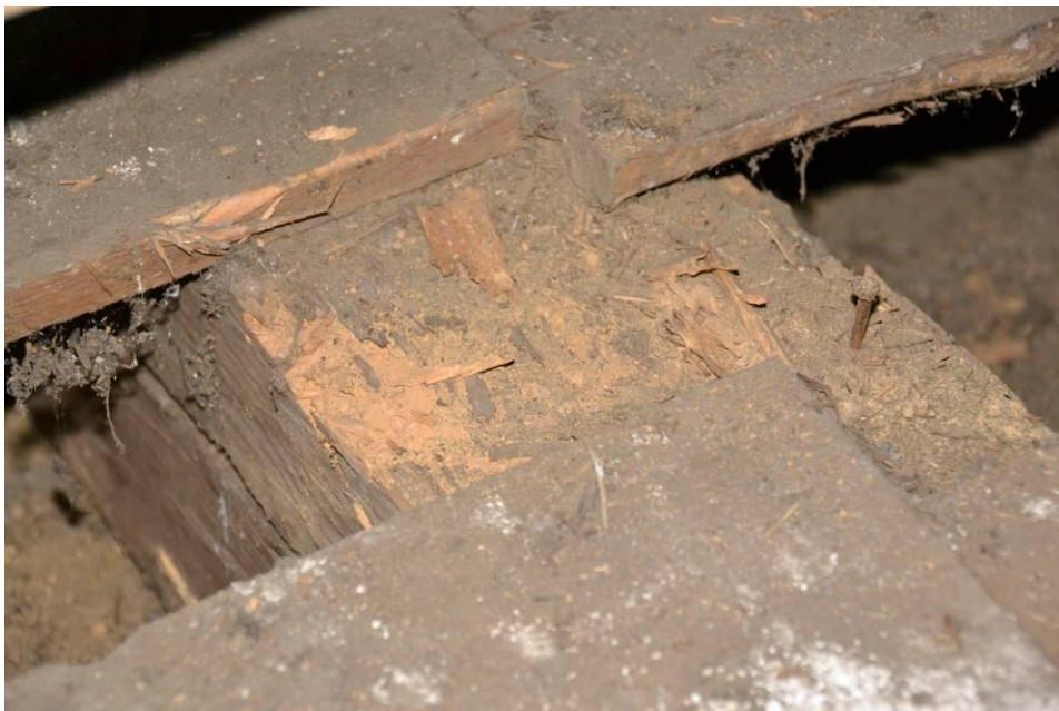
Porażona przez owady belka stropowa nad nawą środkową
