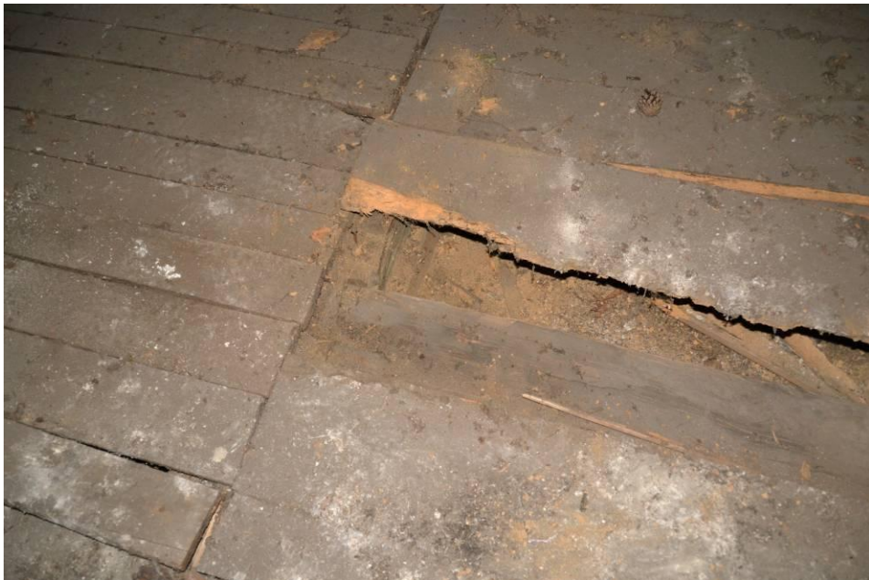
Skorodowane deski starej podłogi na strychu
