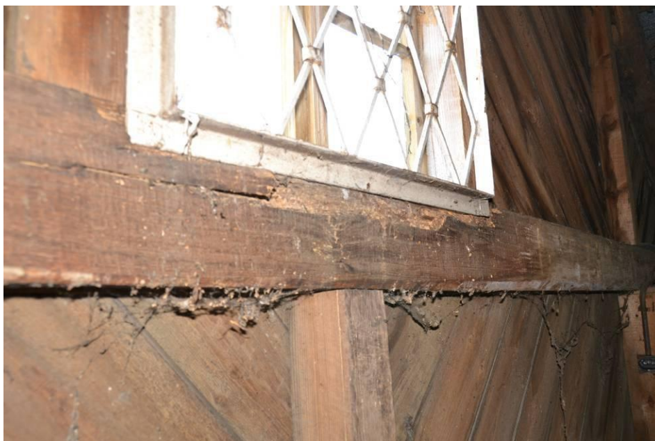
Skorodowane z powodu porażień przez owady jętka w szczycie dachu od strony północnej
