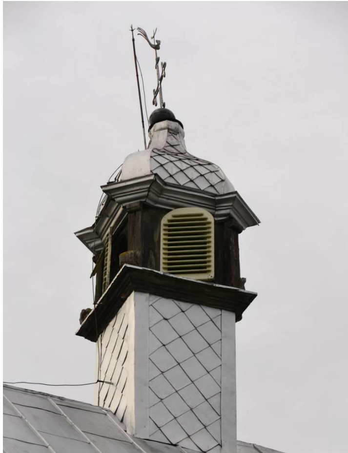
Nieszczelne ażurowe okiennice na wieżyczce z latarnią.
