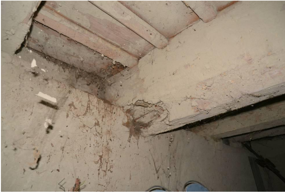
Stara belka stropowa – czop belki porażony przez grzyby domowe, całość opryskana zaczynem cementowym.
