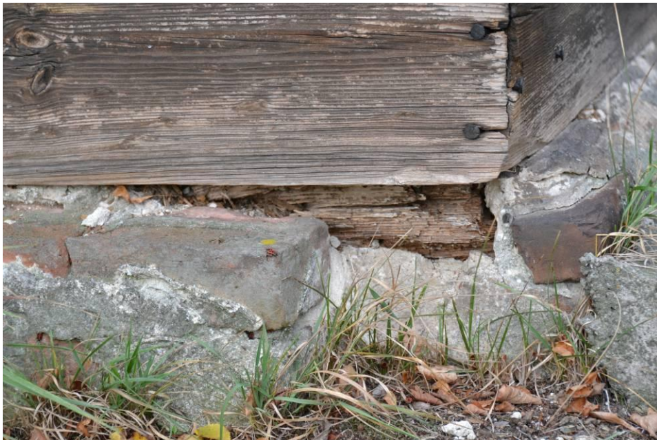
Skorodowana podwalina porażona przez owady i grzyby domowe w narożu południowo-wschodnim prezbiterium.
