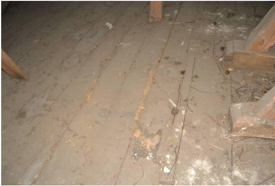
Porażone przez owady deski podłogi przy konstrukcji wieżyczki
