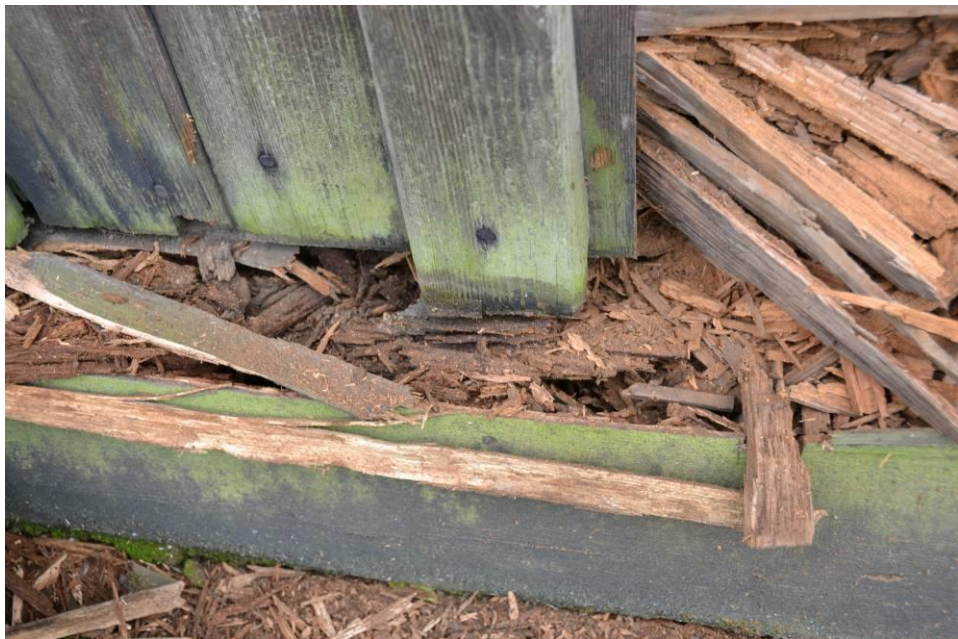
Całkowita destrukcja podwaliny i bali ściany wieńcowej nad podwaliną od strony północnej przez grzyby domowe.
