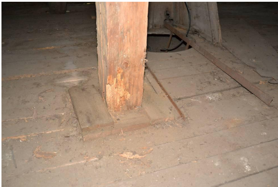
Zniszczony przez owady dolny fragment stolca w ramie zachodniej oraz zniszczony kanał odprowadzający wilgoć z nawy zachodniej
