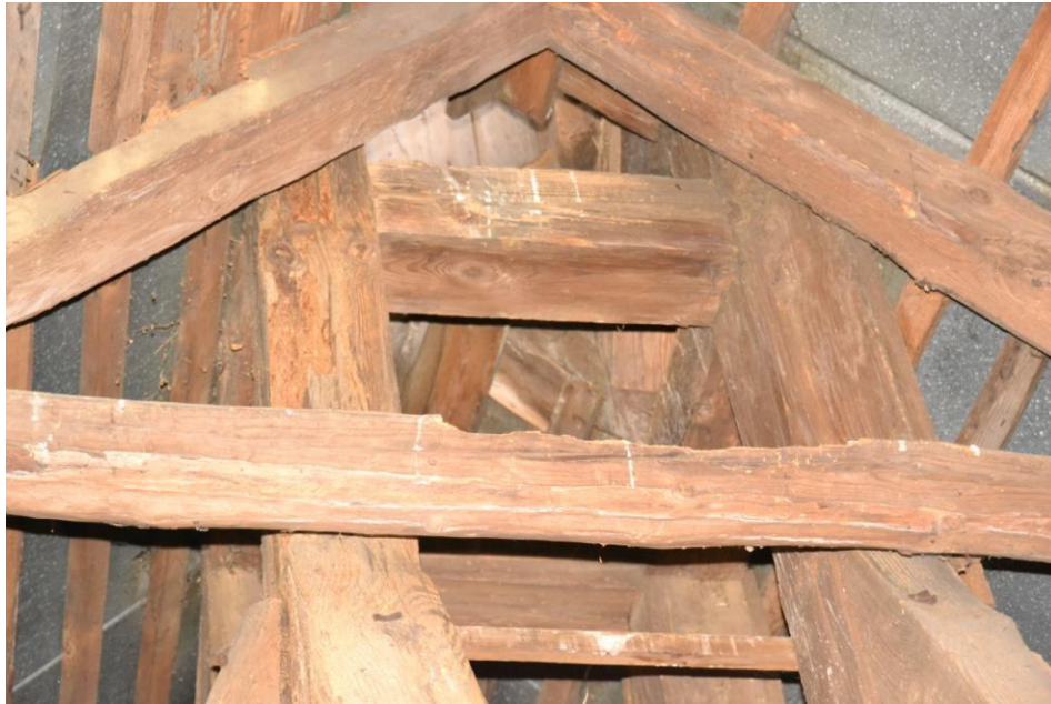
Zniszczone górne części krokwi oraz jętka górna przy konstrukcji wieżyczki z powodu porażień przez owady
